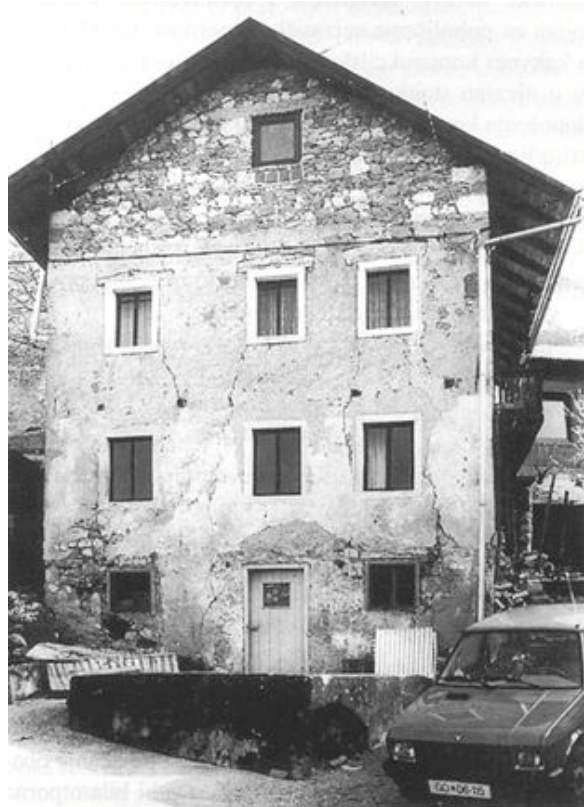
Slika 3. Drežniške Ravne, 1998: vertikalne pukotine u zidu prouzročene savijanjem izvan ravnine
