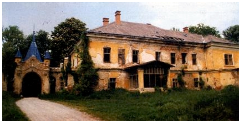
Sadašnje stanje zapuštenog jugoistočnog pročelja
