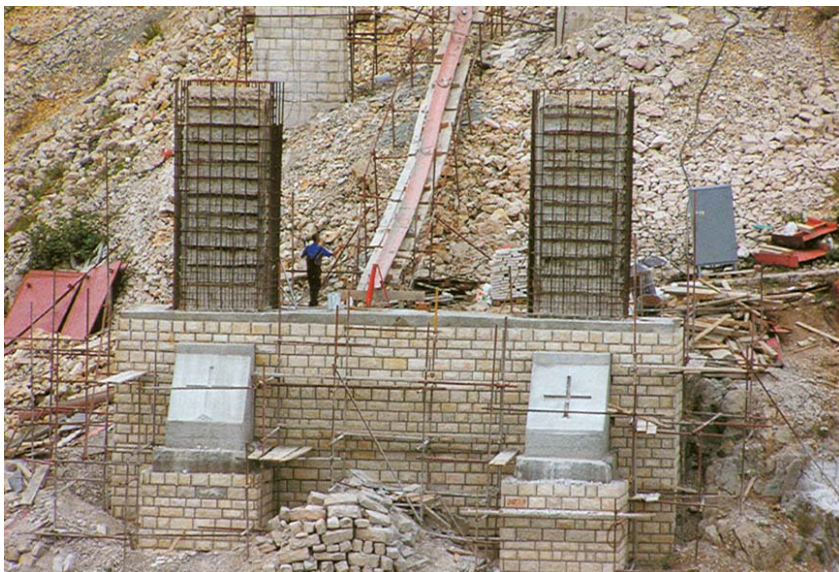
Temeljni blok s armiranobetonskim dijelovima portalnog stupa i oznakama položaja ležajeva lukova
