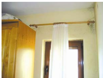
Primjer unutrašnje kondenzacije zbog neispravno izoliranoga vanjskog zida
