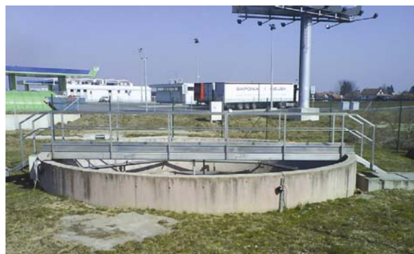
Slika 1. Biološki bazen i sekundarna taložnica uređaja za pročišćavanje otpadnih voda trgovačkog centra Mercatone
