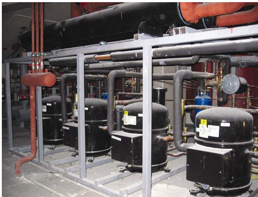
Toplinska pumpa u kotlovnici hotela
