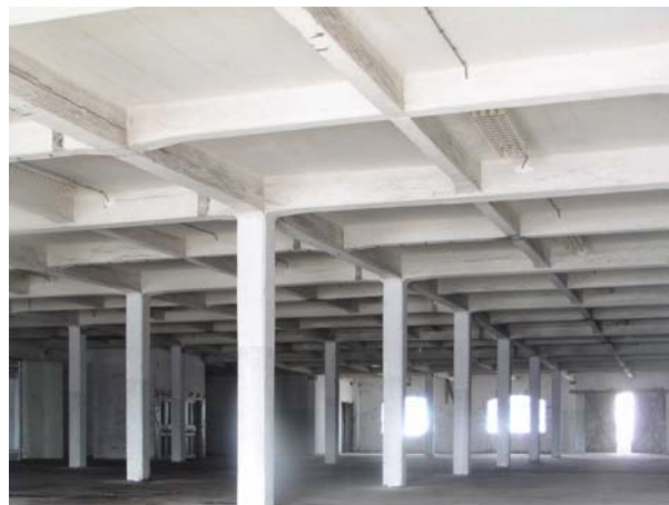
Slika 5. Lučko skladište 17 na Visinovom gatu, autor Ferenc Pfaff, 1906., skeletna konstrukcija 2. kata (foto D.K.)
