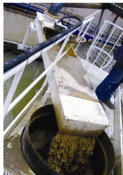
Ulaz prljave vode, preliv čiste vode
