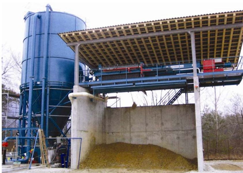
Postrojenje za čišćenje vode
