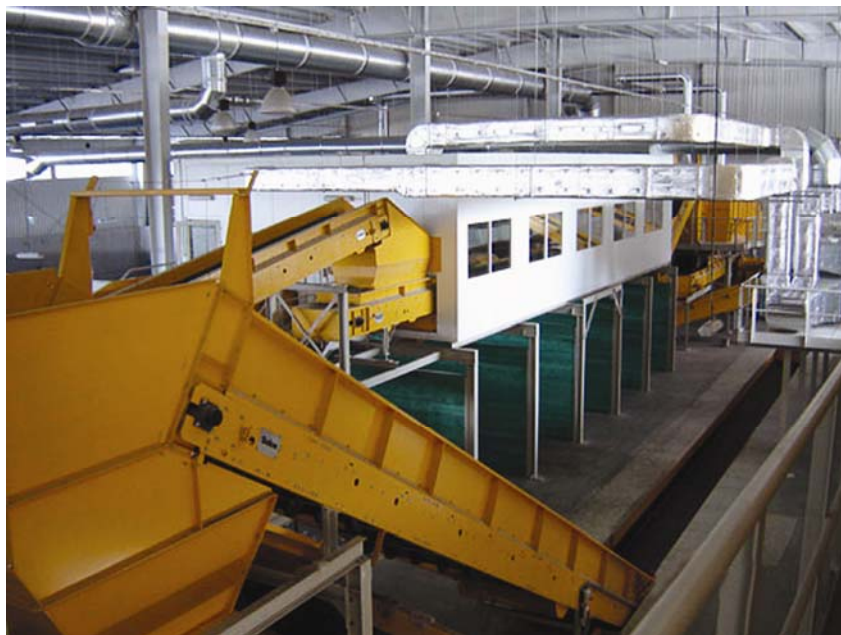
Dio postrojenja u centru za gospodarenje otpadom
