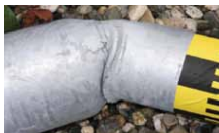
Slika 7. Detalj stupa nakon pada na tlo [6]
