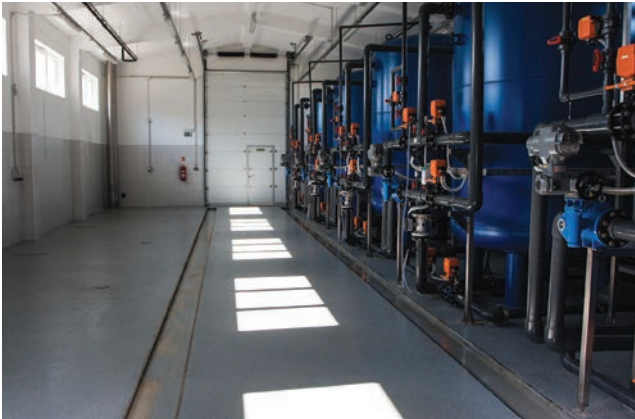
Unutrašnjost crpilišta Bikana u Virovitici (izgrađeno)
