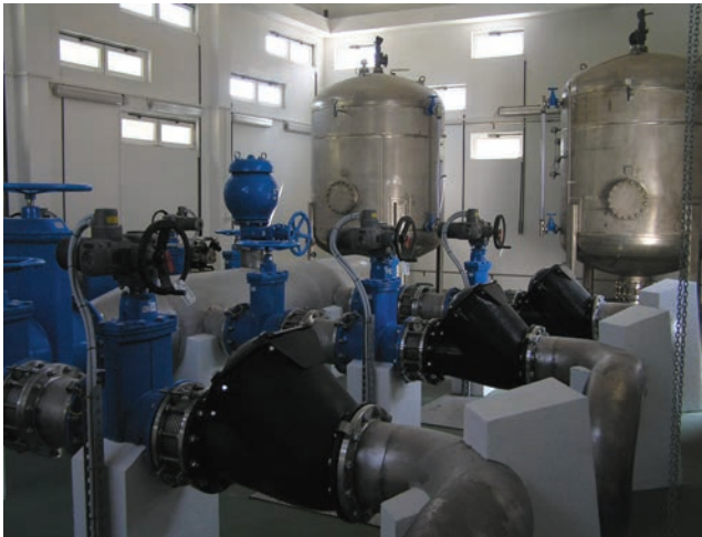
Unutrašnjost crpne stanice Mandalina u Šibeniku (izgrađeno)
