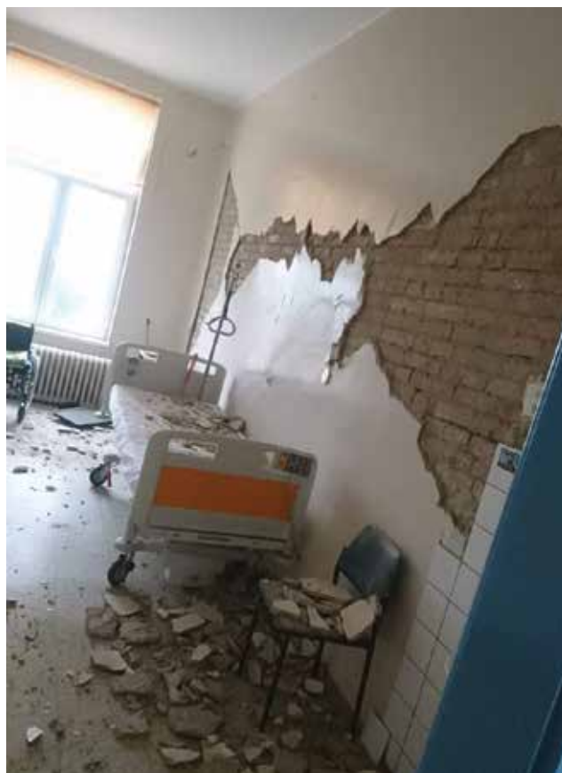
U potresu su oštećene mnoge bolnice
