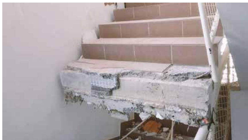
U mjestima oko epicentra potresa značajno su oštećene obiteljske kuće
