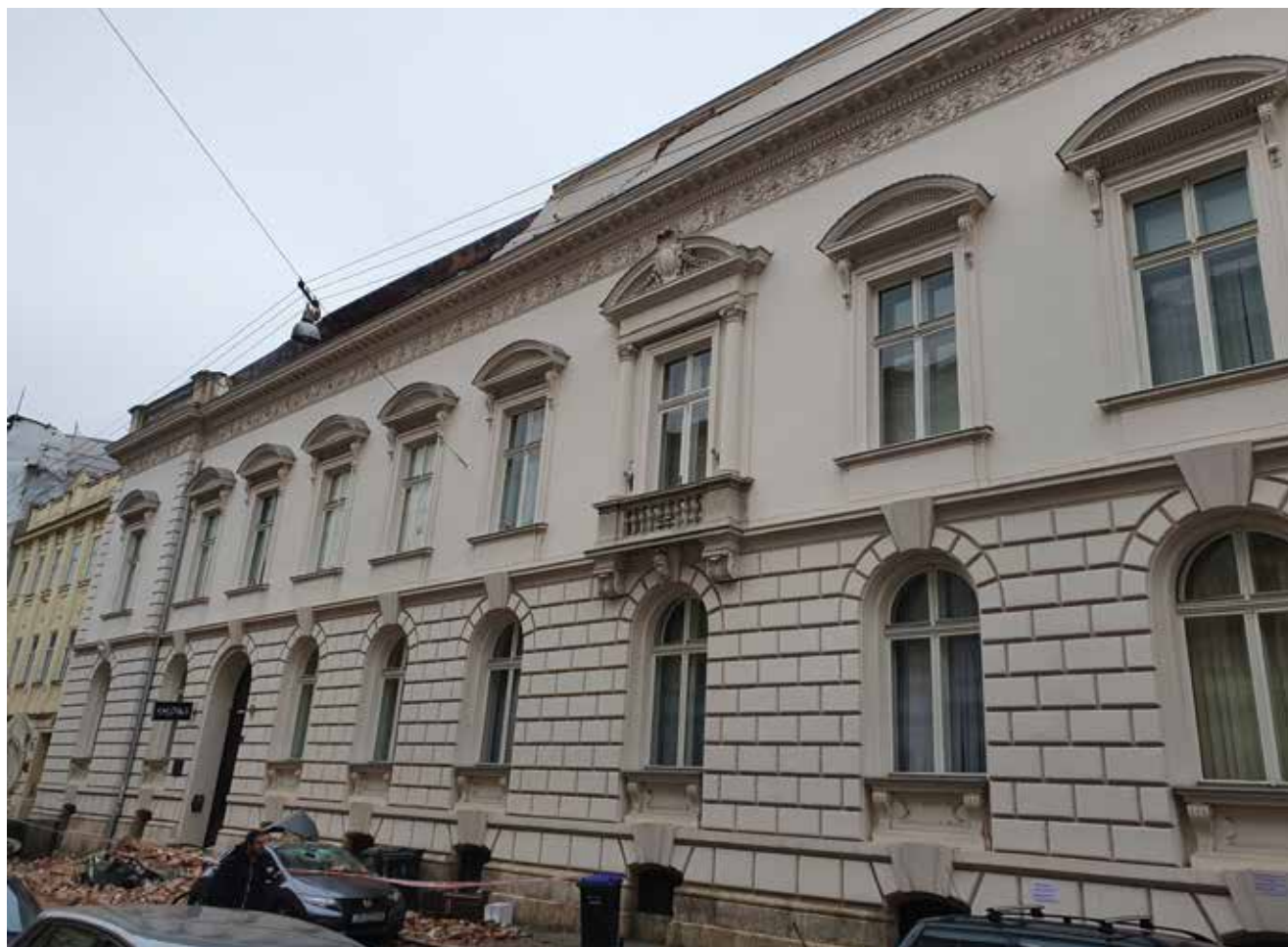
U potresu je značajno oštećena zgrada Hrvatskog inženjerskog saveza
