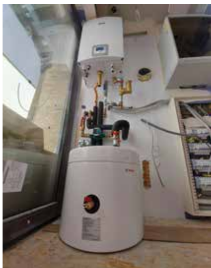
Ugodnu temperaturu u prostoru omogućava dizalica topline zrak-voda
