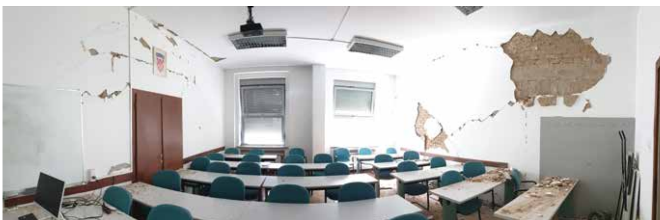
Vidljiva pukotinska oštećenja na nenosivim elementima nakon potresa
