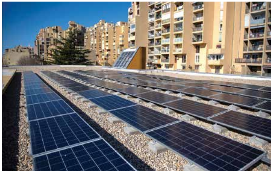
Solarni paneli na krovu Osnovne škole Mertojak
