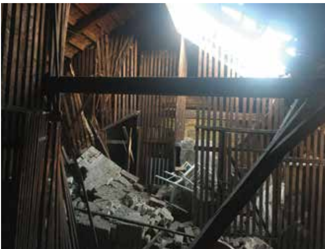
Urušavanje krova zbog pada dimnjaka nakon potresa
