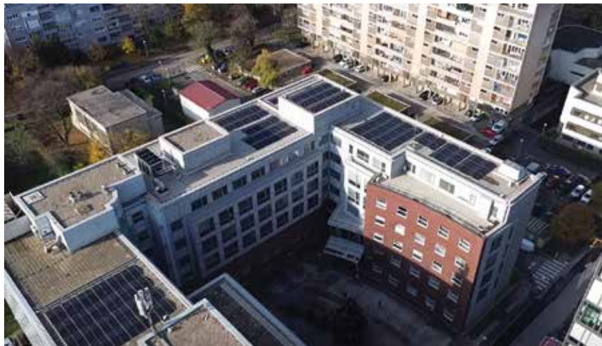
Sunčana elektrana na krovu Elektroprojekta
