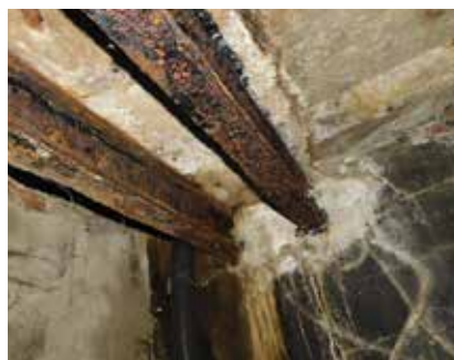
Slika 4. Korozija čeličnih nosača hodnika na mostu
