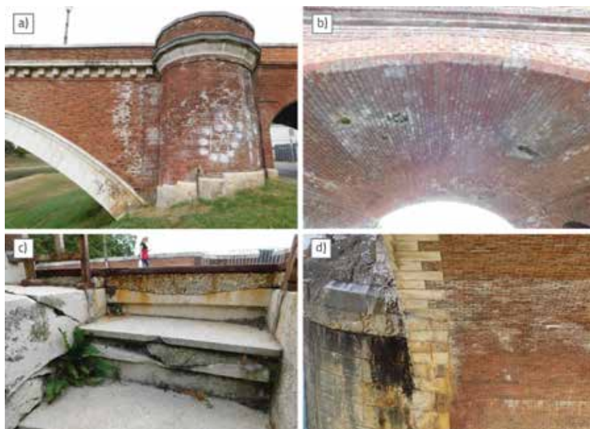
Slika 5. Zatečena oštećenja: a) izluživanje na zidanim sklopovima mosta, b) manje pukotine na zidovima, c) oštećenja prilaznih kamenih stubišta, d) odlamanje kamena na stupištima
