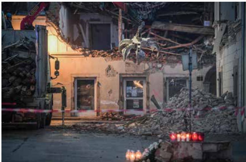
Stare zidane građevine u potresu su najviše oštećene (Foto: Sandra Šimunović/PIXSELL)
