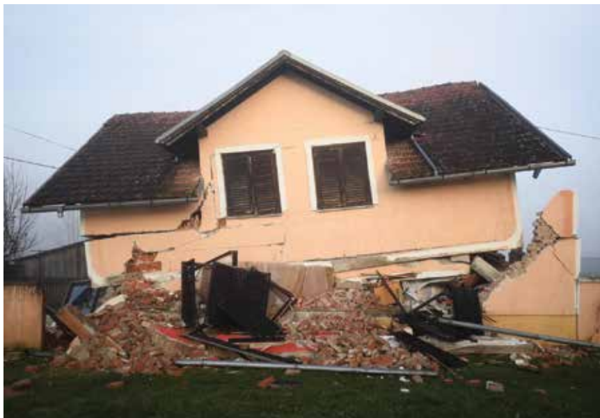
Teško oštećena obiteljska kuća u Prekopi kraj Gline (Foto: Marko Lukunić/PIXSELL)
