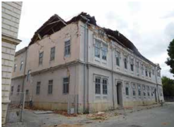
Zgrada Prve osnovne škole u Petrinji nakon potresa
