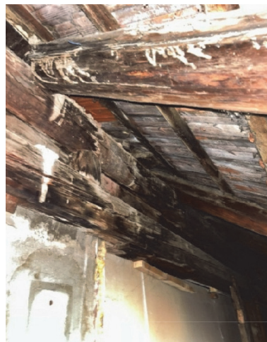
Slika 4. Drvena konstrukcija oštećena djelovanjem bioloških nametnika
