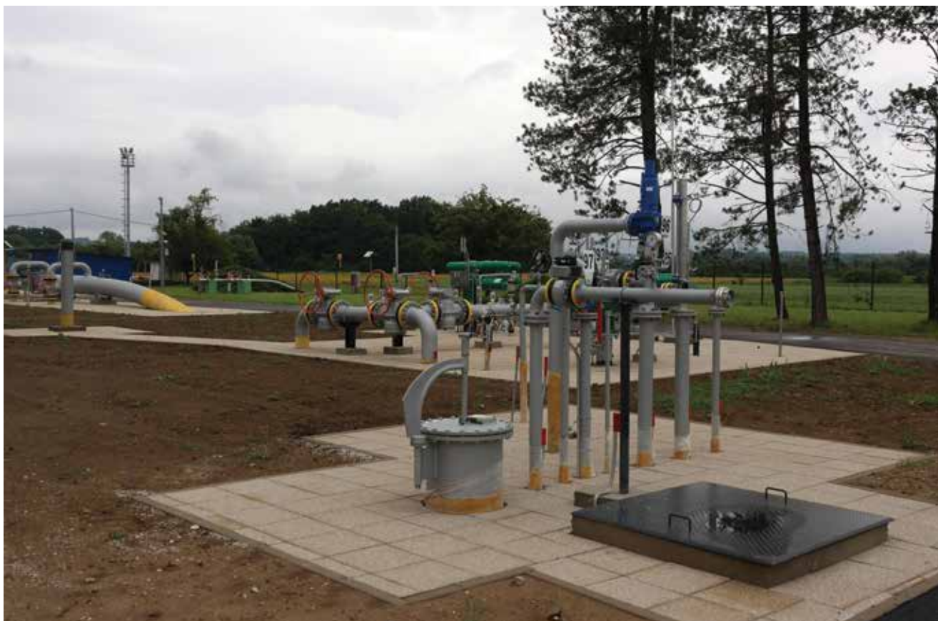
Pogled na plinovod u Zaboku (foto: KZZ)
